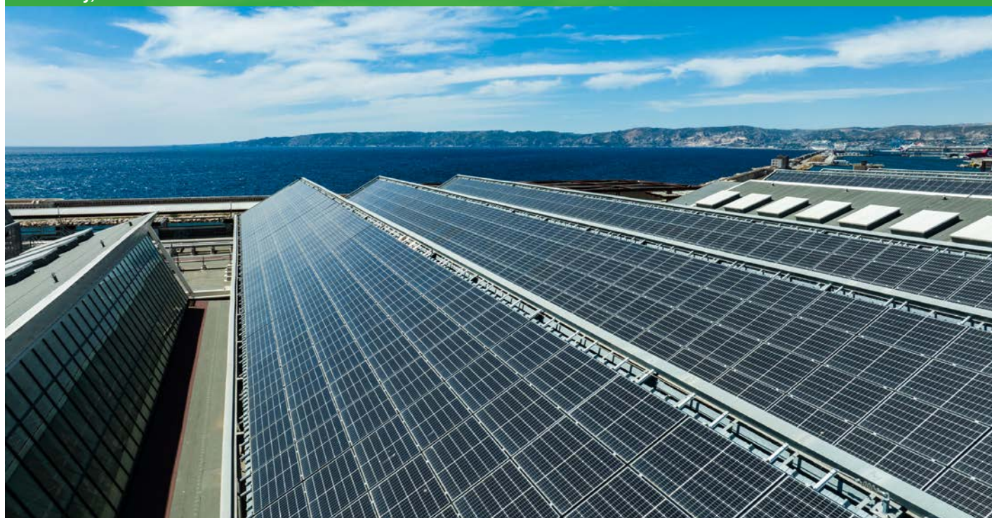
Solar array, Les Terrasses du Port
