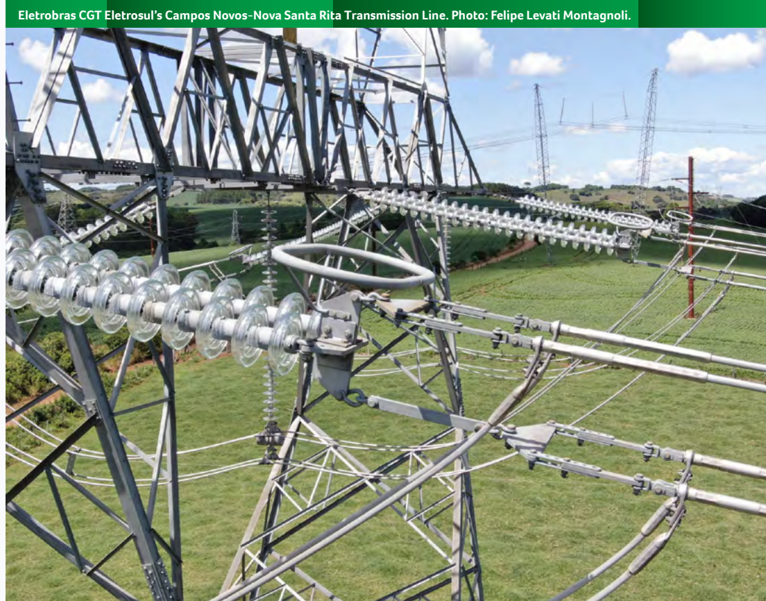
Eletrobras CGT Eletrosul’s Campos Novos-Nova Santa Rita Transmission Line. Photo: Felipe Levati Montagnoli.
